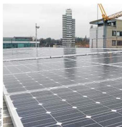
Photovoltaik auf dem Verwaltungsgebäude
